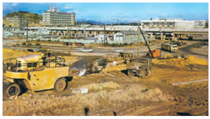
工事中の南地区センター(現在の南千里駅)付近。写真提供：千里ニュータウンの建設。大阪府公文書館所蔵
